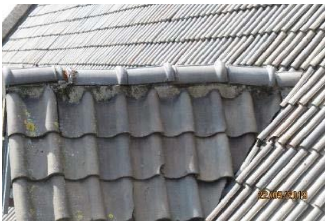
Daken: gebreken bij nokken, gevelaansluitingen en goten
